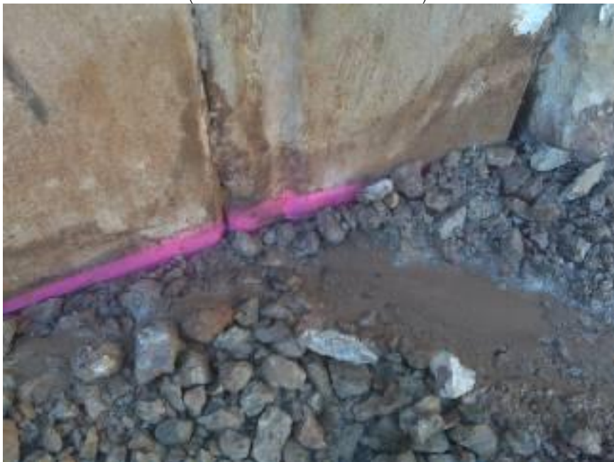
Figura 2.21.- Filtración lateral a través de las planchas de un tablestacado con arrastre de finos (Cortesía de FERRER, S.L.).
