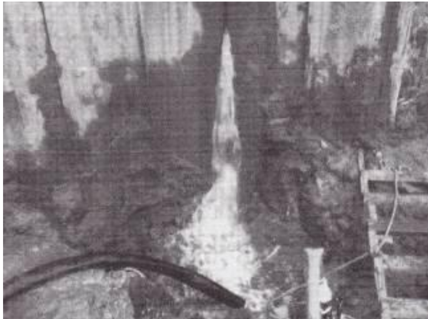
Figura 2.20.- Filtración lateral de agua a través de las planchas de un tablestacado (Cortesía de MORETRENCH).
