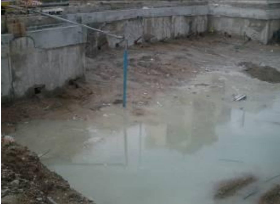
Figura 2.24.- Imagen del estado de la obra por filtraciones laterales a través de los sistema de anclajes del muro pantalla, con sistema de drenaje interior funcionando. Gandia – Valencia. (Cortesía de FERRER, S.L.).
