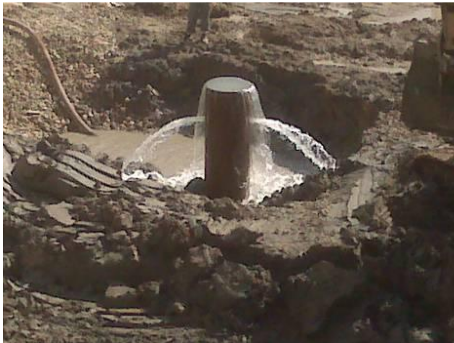
Figura 2.17.- Imagen de surgencia en fondo de excavación. Valencia, 2009 (Cortesía de FERRER, S.L.).
