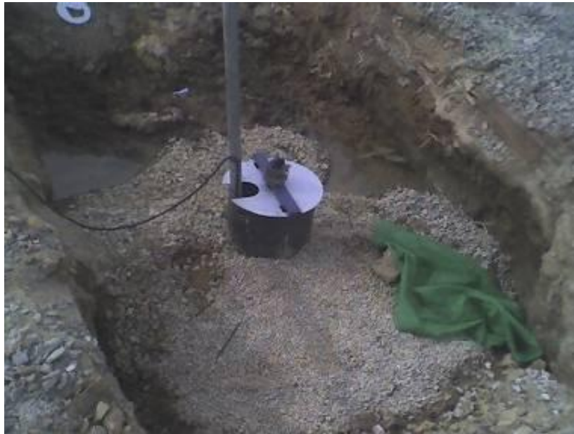
Figura 3.3.- Imagen de sumidero ( sump ) completamente equipado, previo a la ejecución de la excavación (cortesía de FERRER, S.L.).
