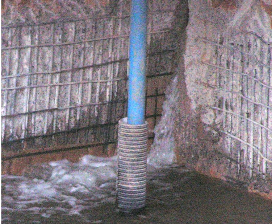
Figura 2.22.- Filtración lateral de agua a través de fallo de construcción de muro pantalla (Cortesía de FERRER, S.L.).
