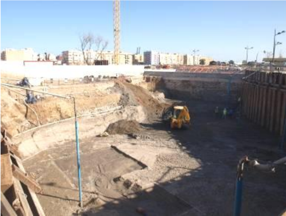
Figura 3.28.- Control de nivel freático con sistema combinado, wellpoint doble estadio y pozos profundos.(Cortesía de FERRER, S.L.).
